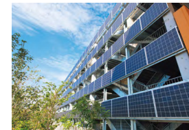
ららぽーと和泉 太陽光パネル
