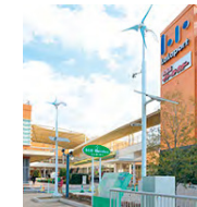
ららぽーと新三郷 小型太陽光発電機付き風力発電機
